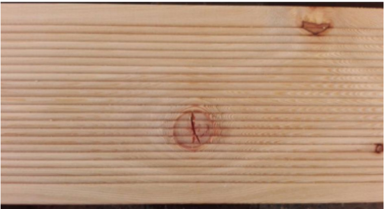
Foto 6 – ein aufgerissener, herausbröckelter Ast
